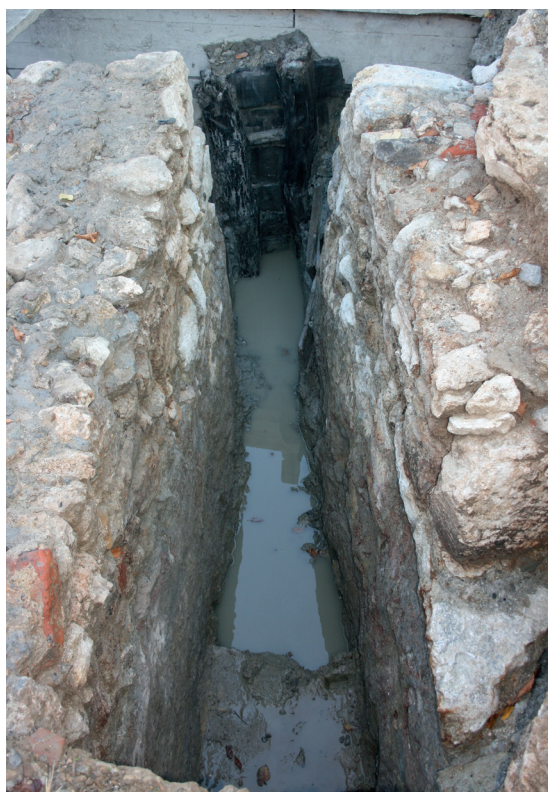
Slika / Figure 6: Zidani kanal, južno od izvorišnog bazena, koji je vjerojatno služio za pražnjenje vode (snimila D. Kušan Špalj). / Stone-built canal to the south of the spring reservoir, probably used for drainage (photo by D. Kušan Špalj).
