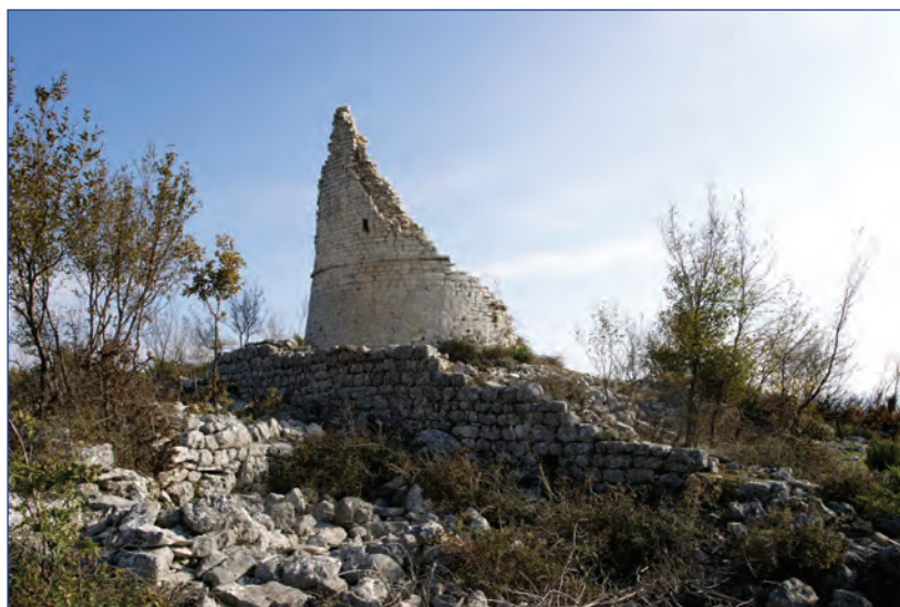
Slika 3: Kula i obrambeni zid na položaju Gradina, Otavac (snimio: N. Vujnović, Kaducej d.o.o.).
